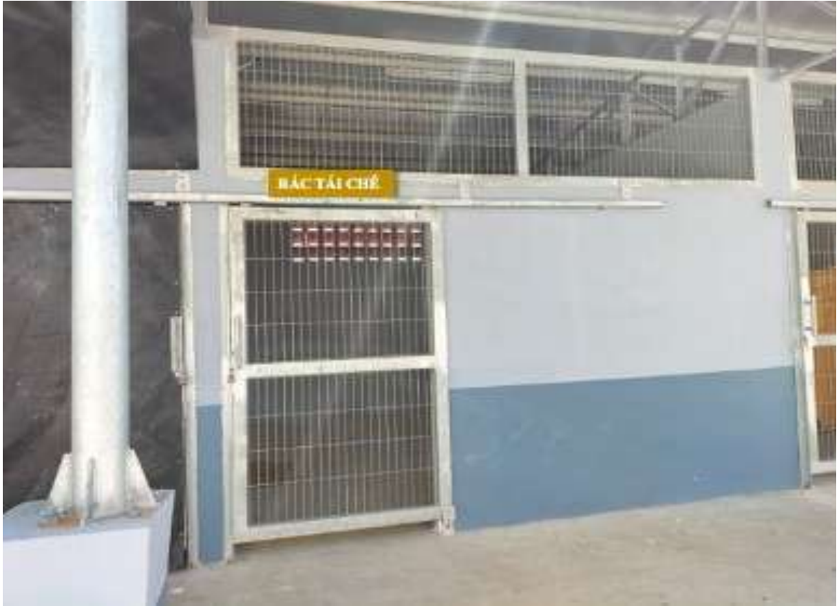
Hình 4.7: Nhà chứa rác tái chế của dự án
