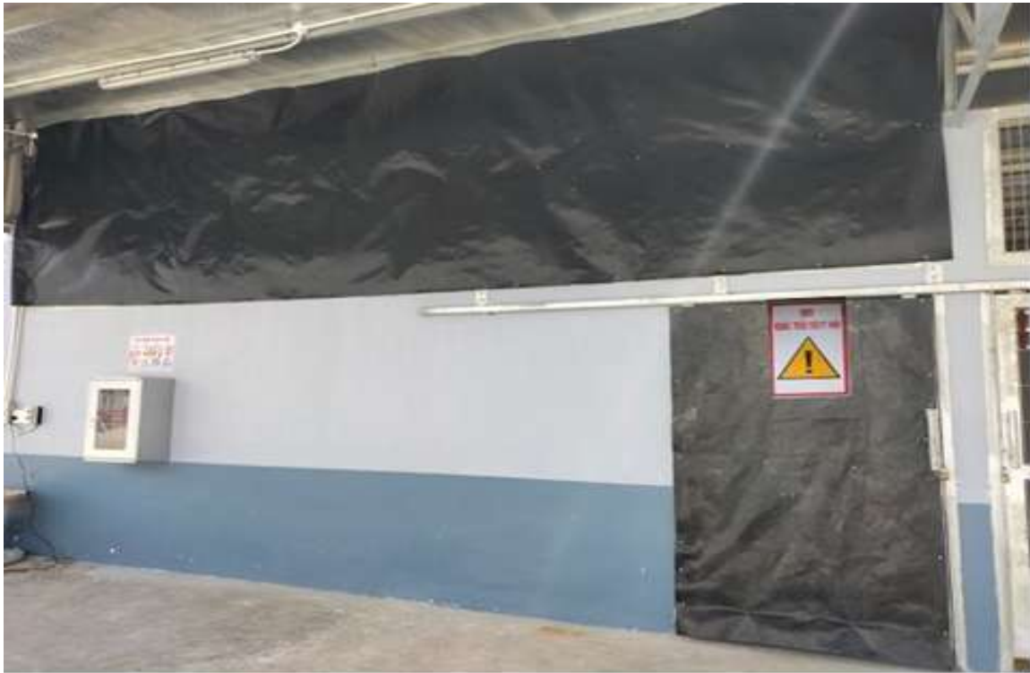
Hình 4.8: Kho chứa chất thải nguy hại của dự án
